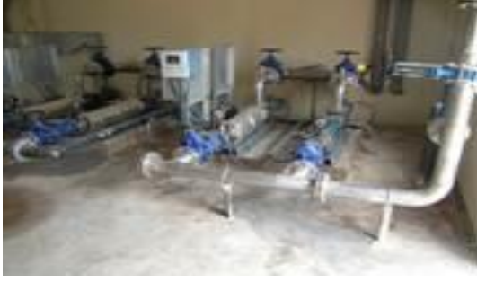
Şekil 2. Besleme pompaları Figure 2. Feed pumps
