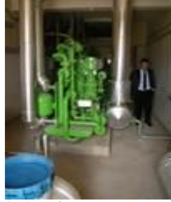
Şekil 7. Biyogaz Jeneratörü Figure 7. Biogas Generator
