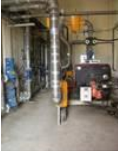
Şekil 6. Kazan Figure 6. Boiler
